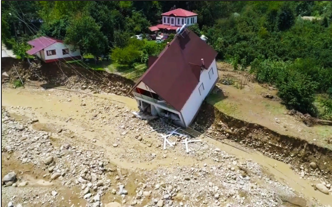
Fotoğraf 6: Esmahanım köyünde dere yatağındaki evlerin sel sonrası durumu (İHA, Temmuz 2019).
